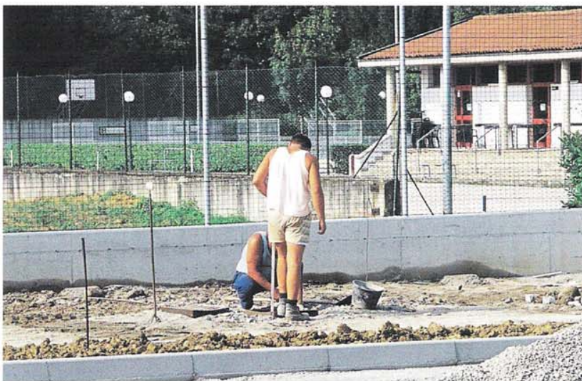
Con riferimento all'esposizione al rumore che supera 85 dBA, l'art. 44 del D.L. 277/91 impone l'obbligo di una specifica sorveglianza sanitaria integrata dall'esame della funzione uditiva; la vaccinazione antitetanica è obbligatoria per gli operai e i manovali addetti all'edilizia e per gli asfaltisti (art. 1 della L. 292/63).
